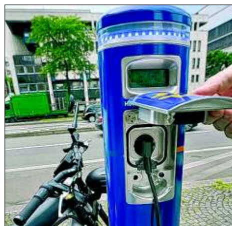
Hier wird Ladestrom aus der Stromtankstelle vor der Leonhardskirche gezapft Foto: Kienzle
